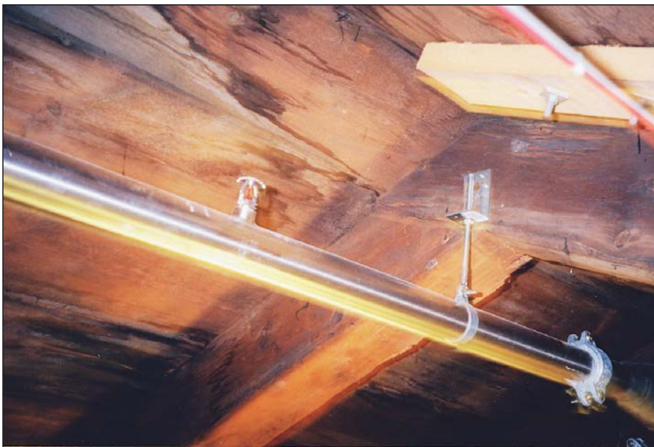
Oförstörande rörupphängning på kyrkvinden. Observera principen med klenare skruv i stället för borrar för fransk träskruv.
