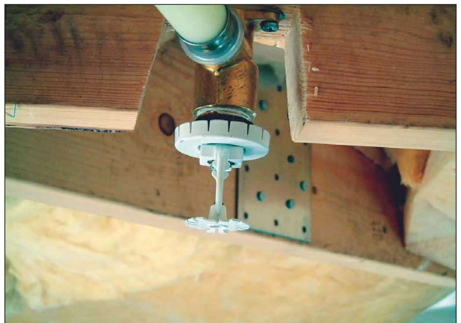
Boendesprinkler monterad i Pex-rördel och koppling för dolt montage.
